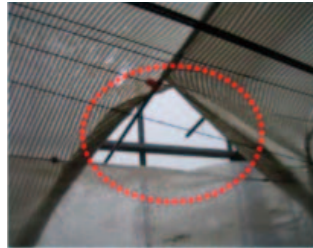
天井カーテンの隙間 (裏面)
