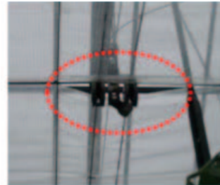
天井の滑車付近の隙間
