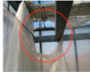
温室のコーナー部の隙間
