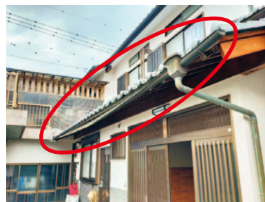
雪の重みで変形した樋
