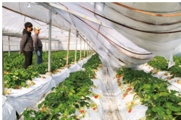
大雪で倒壊したハウス
