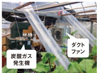
図2 ダクトの設置例(促成ナス)
